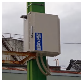
電源・制御盤
