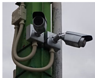
カメラ(2台)の設置状況
