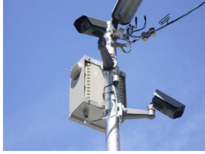
照明ポールへ取付けたカメラと制御BOX
